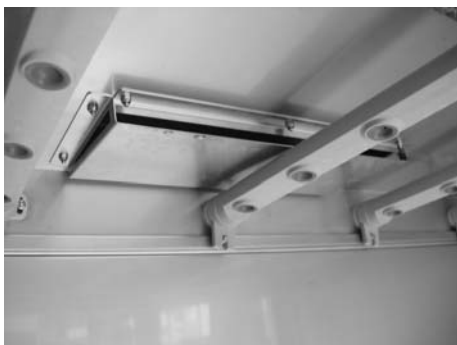
Ansaugkanal der Wrasenabsaugung
